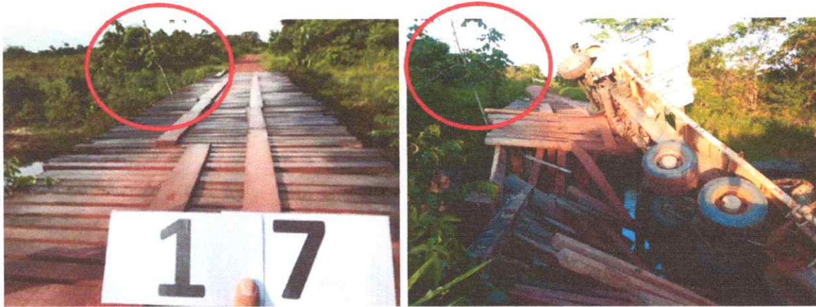
Figura 6. Ponte classificada como crítica no monitoramento realizado dia 19/11/2021, queda da ponte no dia 22/11/2021, devido ao excesso de peso do caminhão, não houveram vítimas.
